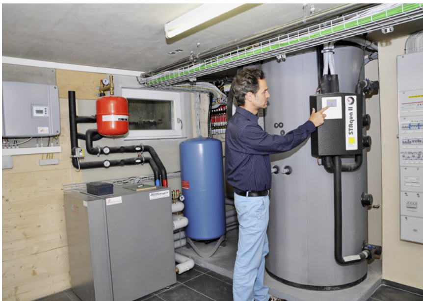
In der Haustechnikzentrale im Keller mussten die drei Energieträger (Sonne, Erdwärme, Holz) aufeinander abgestimmt werden.
